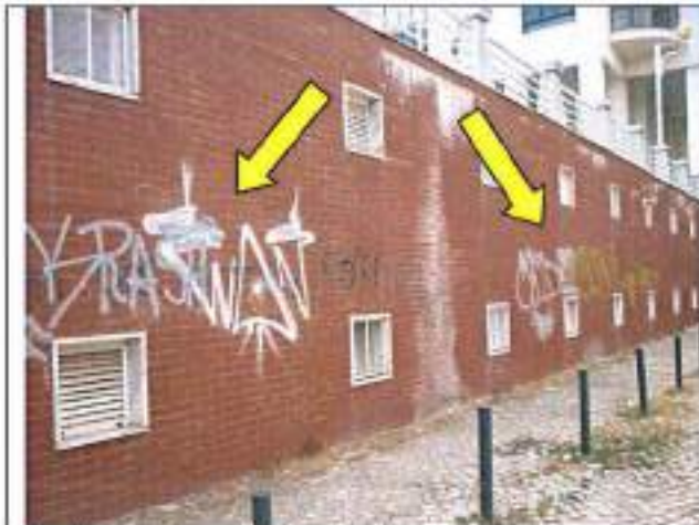
Escrita nas Paredes (Grafitis), solicitar a intervenção da Junta Freguesia na Limpeza
